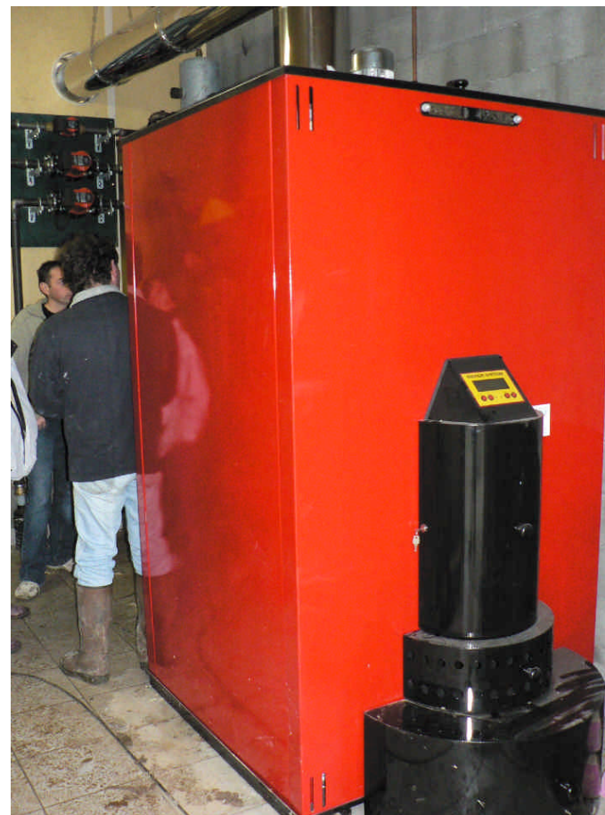
La chaudière et le local chaufferie
